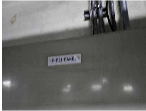
지하주차장 분전함(P-P31 PANEL)-외부
