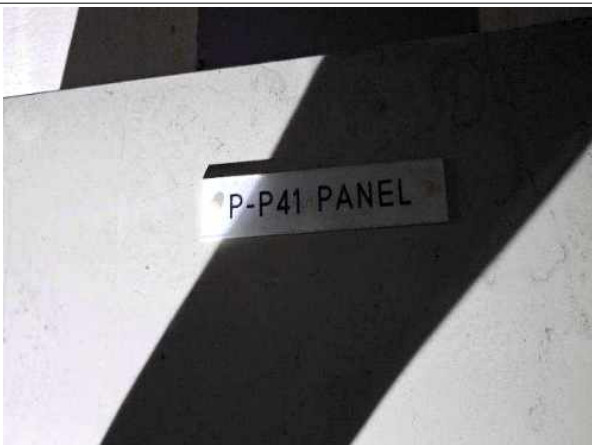
지하주차장 분전함(P-P41 PANEL)-외부
