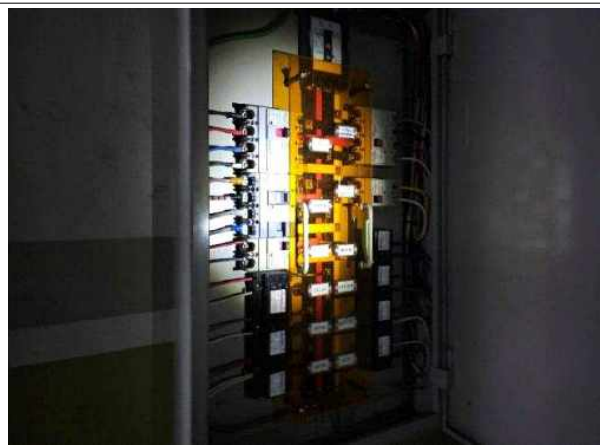
지하주차장 분전함(P-P41 PANEL)-내부
